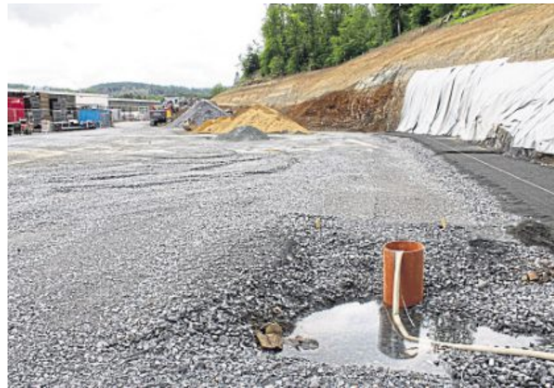
Noch laufen die Arbeiten an der neuen Lagerfläche. Inklusive Zufahrt wurde sie der Böschung am Waldrand abgerungen. Unterirdisch ist dort sogar ein großes Regenrückhaltebecken eingebaut.
